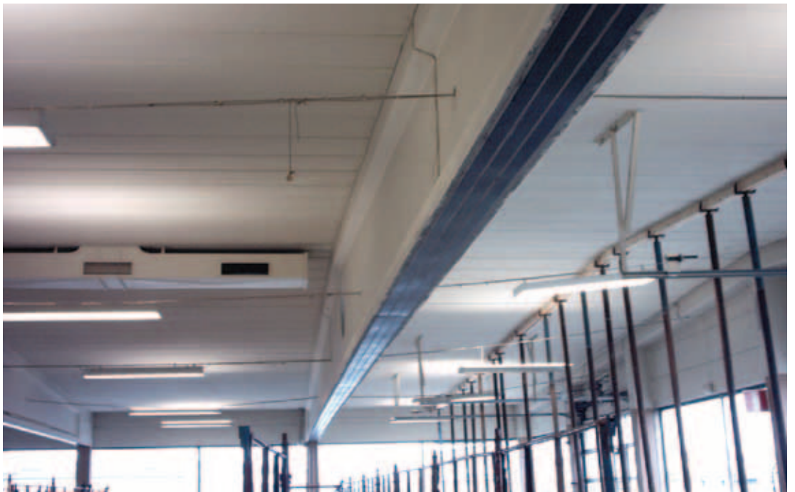
Holmgrens Bil, Jönköping. Exempel på hur balkar förstärks på grund av snölast .
