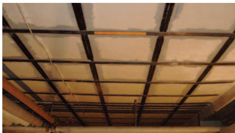
Systembolaget i Skara. Bjälklagets kapacitet höjdes från 400 kg/m 2 till 1000 kg/m 2 . Parkeringshuset under lokalen påverkades inte av förstärkningen.
